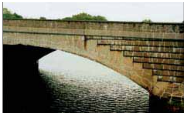
Abb. 1: Stahlbeton-Bogenbrücke mit Schädigungen infolge Überlastung, Fundamentsetzungen und Durchfeuchtung
