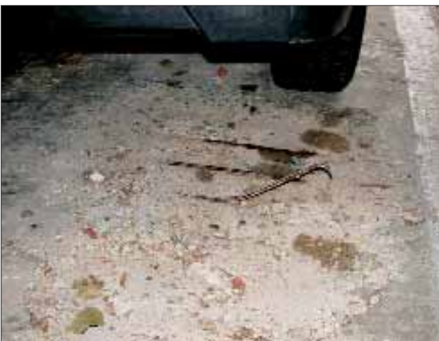
Abb. 2: Zerstörte Betonoberfläche mit herausstehender Bewehrung in einem befahrenen Bereich eines ca. 30 Jahre alten Parkhauses
