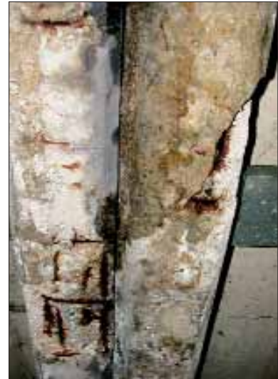
Abb. 3: Erhebliche Korrosionsschäden an Unterzügen eines Parkhauses, die an eine undichte Fuge angrenzen
