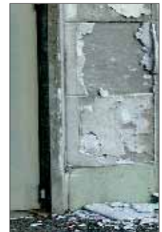
Abb. 1: Frostschäden an einer von Schlagregen beanspruchten Porenbetonwand mit diffusionshemmender Beschichtung.
