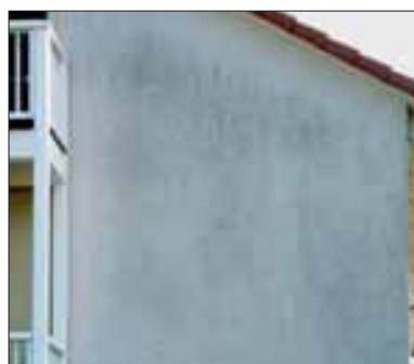
Abb. 8: Algenbewuchs auf der Fassade. Deutlich zu erkennen ist der Einfluss des geringen Dachüberstandes.
