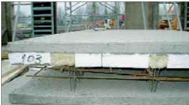
Abb. 4: Falsche Gitterträger erzeugen Wärmebrücken und nicht berücksichtigte Zwängungen
