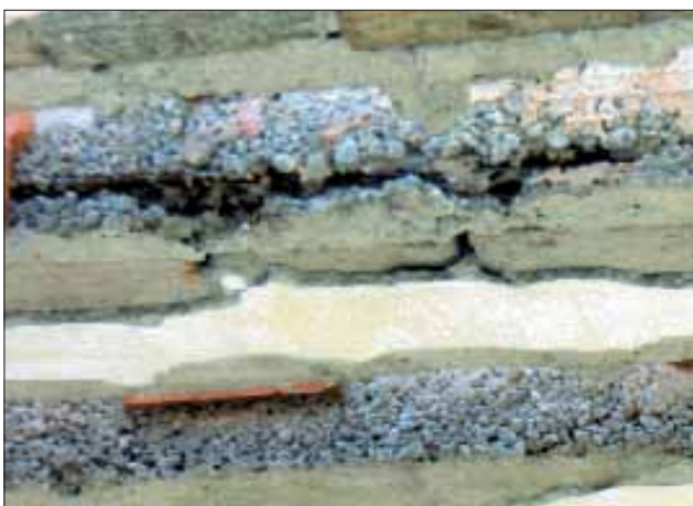
Abb. 5: Beispiel für mangelhaft verdichteten Beton in Stahlbetonrippendecken
