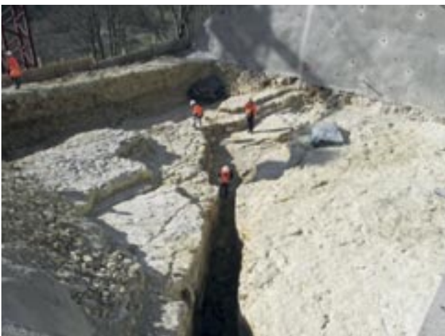
Abb. 9: Großkluft im Bereich des Widerlagers Achse 10
