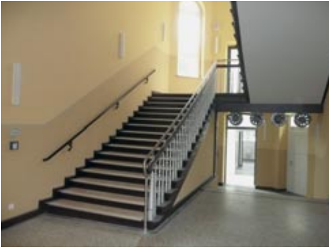
Abb. 22: Bewusst gezeigte Überdruckbelüftung in einem Treppenraum
