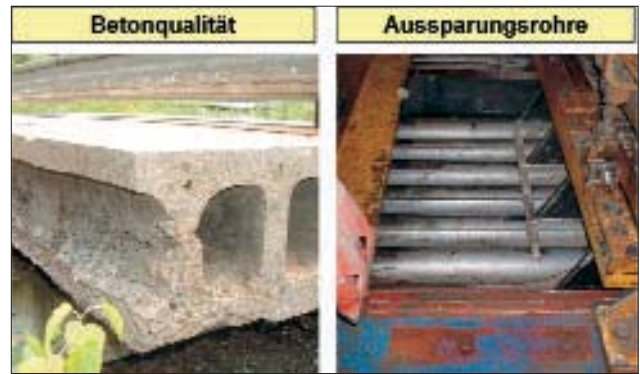
Abb.14: Mangelhafter Stegbeton durch falsch eingestellte Betonrezeptur
